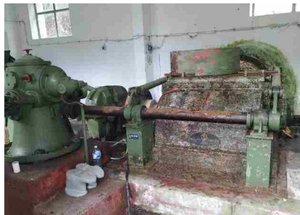
Slika 6: Izgled turbinskog sklopa mHE „Rijeka Crnojevića“
