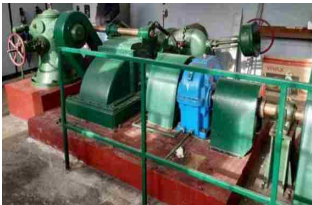
Slika 5: Izgled turbinskog sklopa mHE „Podgor“
