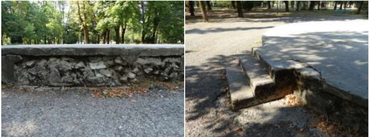
Slika 16. Izgled scene sa oštećenjima i stepeništem
