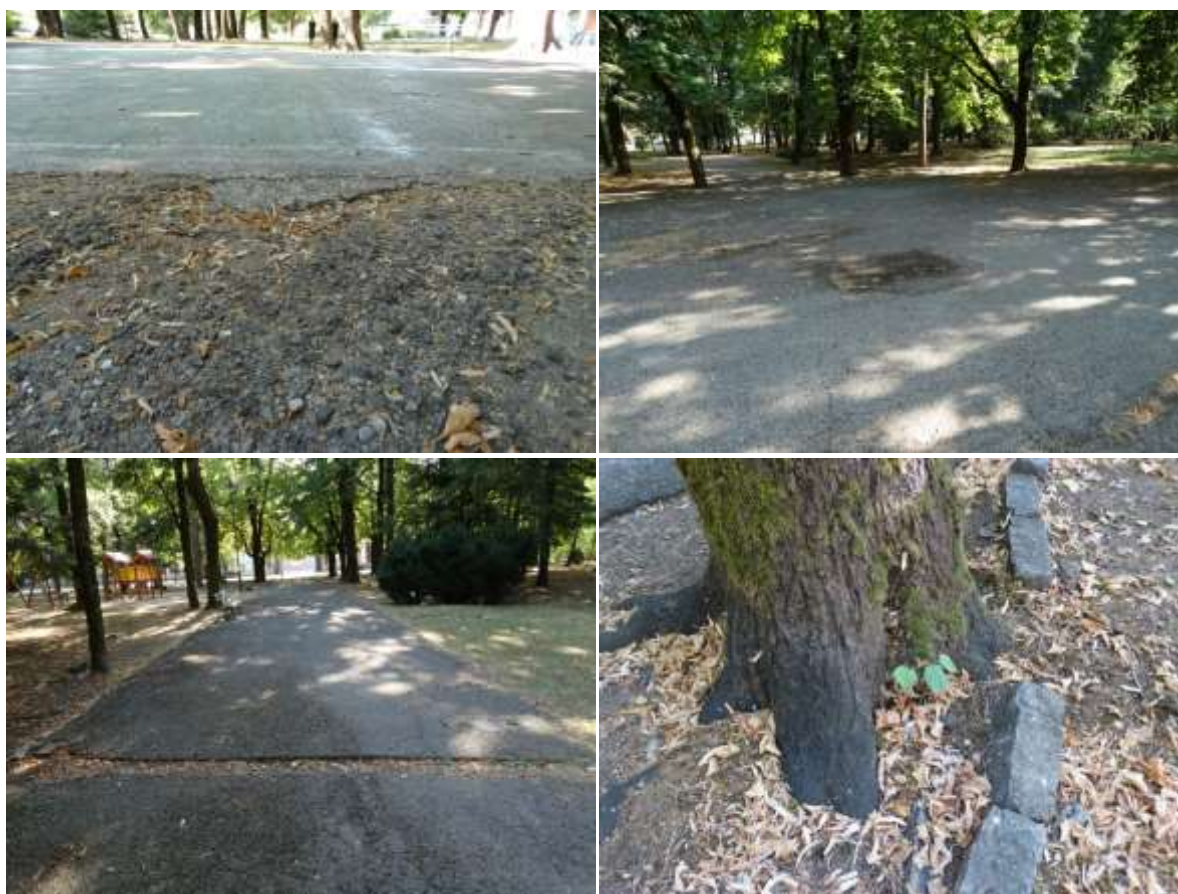
Slika 22. Oštećenja asfalta na hodnim linijama i neadekvatno postavljeni ivičnjaci
